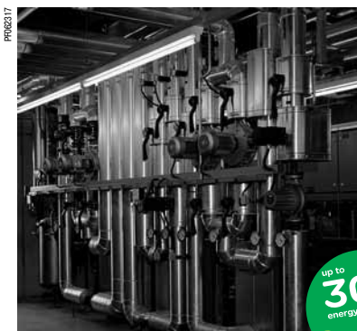
Управление насосной станцией
